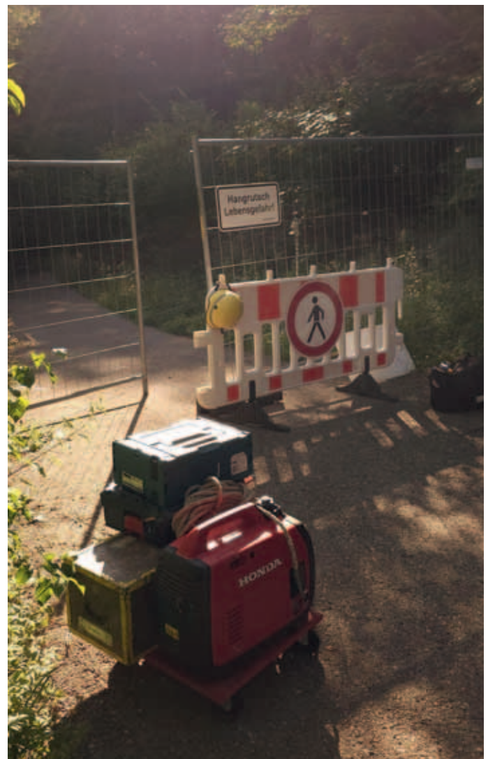
Die Sicherheit erfordert Vorkehrungen schon nach dem Hangrutsch.
