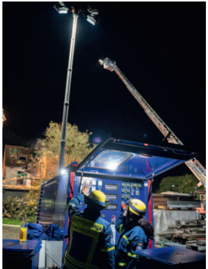
Die Netzersatzanlage (NEA) mit 50 kVA mit Lichtmast hat sich bei der Ausleuchtung und Stromversorgung bewährt.
