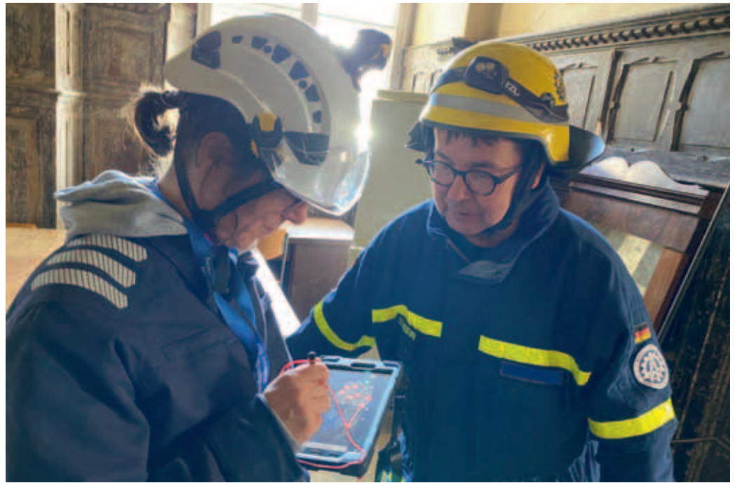
CHRU-Mitglieder bei der digitalen Dokumentation von Schäden am Schloss.
