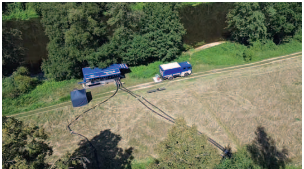
Die Hauptdruckleitung der Börgerhochleistungspumpe wurde in drei Leitungen aufgeteilt, damit mehr Sauerstoff in den Weiher fließt.
