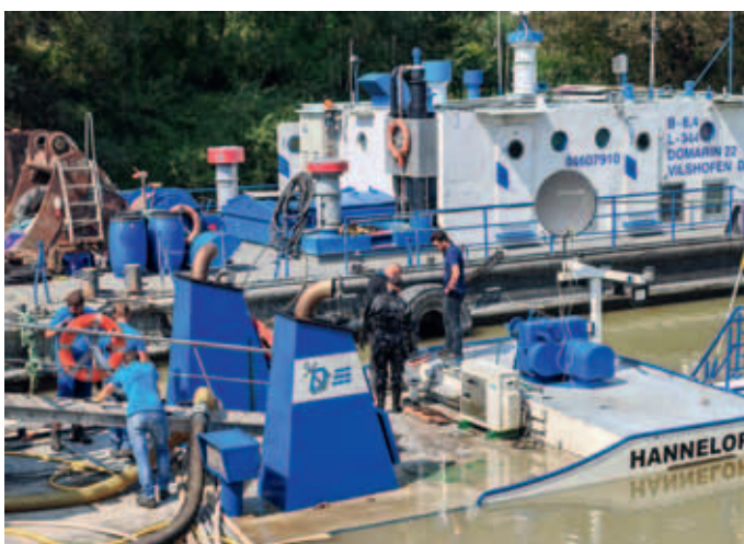
Taucher einer Privatfirma kümmern sich um die Abdichtung von Luken im Inneren des Schiffs.
